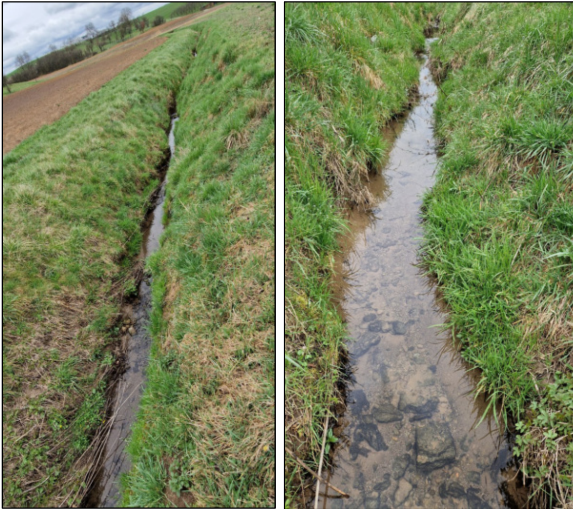
Eingetiefter Verbauabschnitt Brücke oberhalb HRB: vereinzelt mit erodierten Verbausteinen
