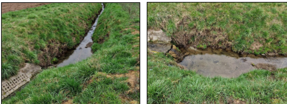
Unterhalb Brücke Vorhabenbereich: Sohlschalenübergang in Erosionskolk: Wenige Steine ohne günstige Habitatbedingungen in Folge dauernder Umlagerung bei Starkregen
