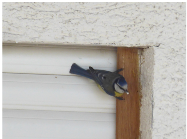
Abb. 32: Blaumeise mit Brut im Rollladenkasten beim Entfernen von Kot.
