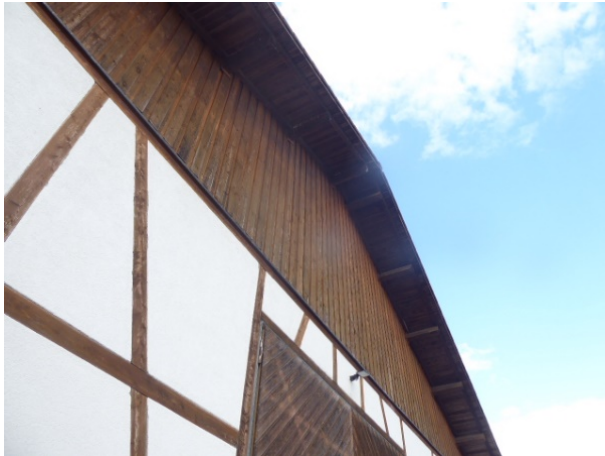
Abb. 20: Östliche Giebelseite der südlichen Halle mit Dachüberstand ohne Vogelneest.
